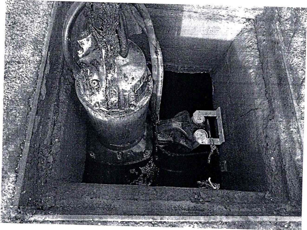
Figura 64 - Pompa da 32 kW - Non è possibile estrarla senza smontare i tubi guida
