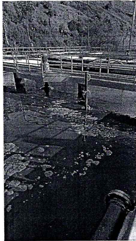
Figura 10 – Tubazione chiusa tramite flangia cieca
