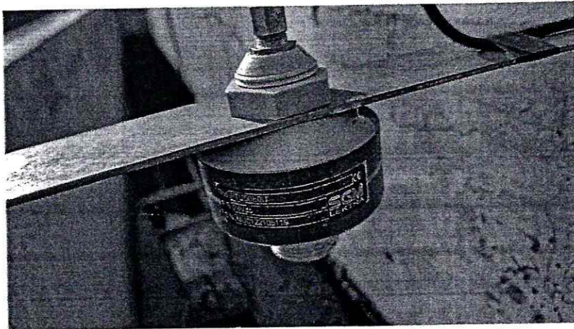
Figura 5 - Misuratore di portata in ingresso.
