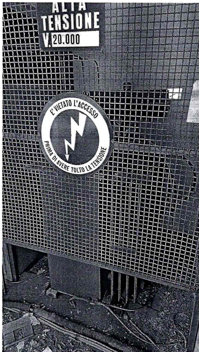
Figura 69 - Trasformatore cabina MT
